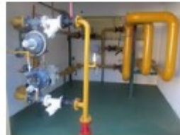
INSTALACIONES DE GAS
